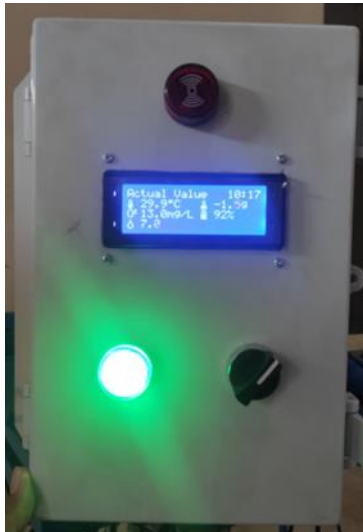
Gambar 12 Tampilan pada box panel
