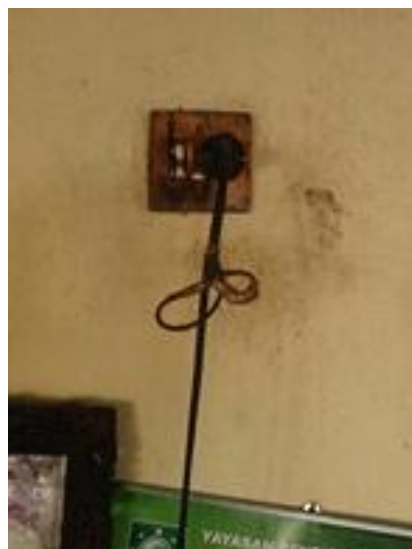
Gambar : 3.25, Stop Kontak yang Tidak Memenuhi Standar
