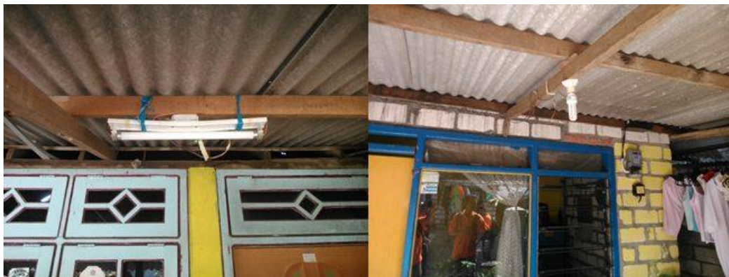
Gambar : 3.24, Pemasangan Lampu yang Kurang Memperhatikan Keselamatan
