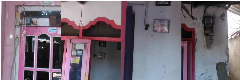
Gamabr : 3.23, Kabel yang Menggantung Memungkinkan Terjadinya Konsleting
