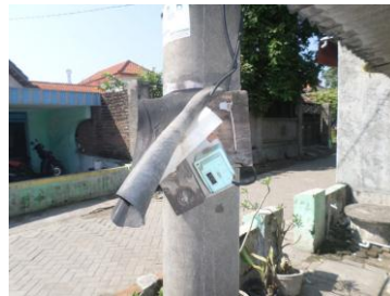
Gambar 3.18, Pemasangan Switch Lampu Jalan tidak memakai pelindung
