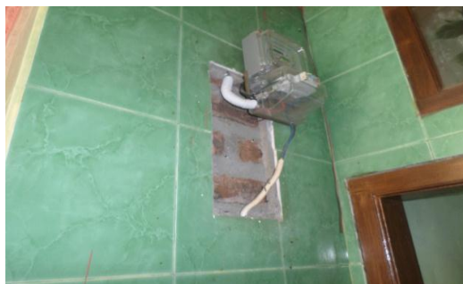
Gambar 3.16, Pemasangan Meteran listrik di dinding yang salah
