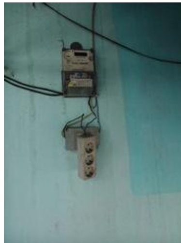
Gambar Stop : 3.22, Kontak tidak boleh dipasang didekat kWh meter untuk menghindari Hubung Singkat
