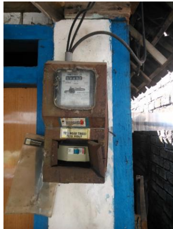
Gambar : 3.21, Instalasi KWh Meter yang tidak Sesuai dengan Standar SPLN
