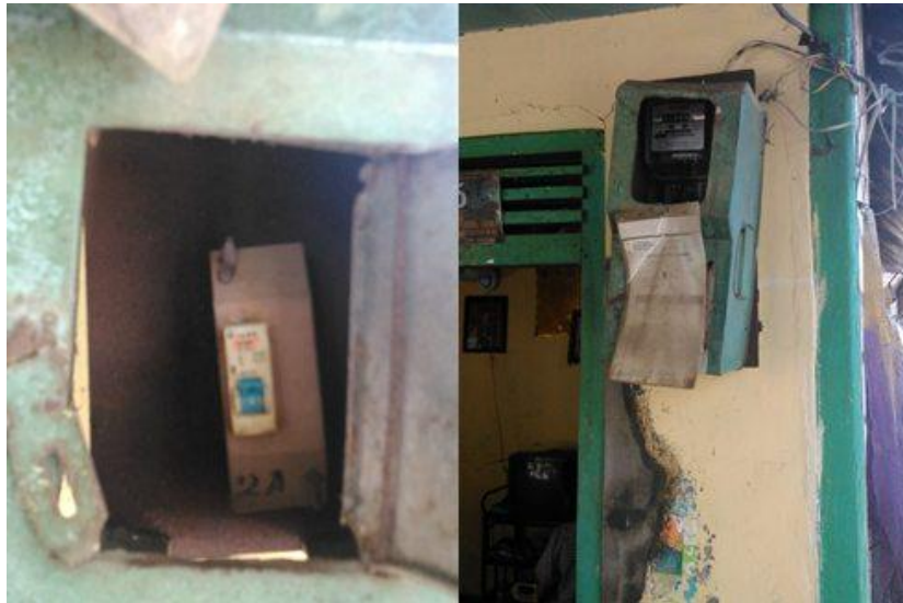
Gambar : 3.26, KWh Meter yang belum memenuhi Standar
