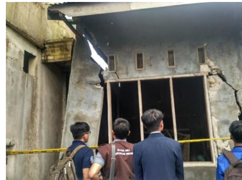
Gambar 7. Kegagalan Ikatan Kolom ke pondasi ( sloof ) Sumber: Kunjungan Lapangan (2018)
