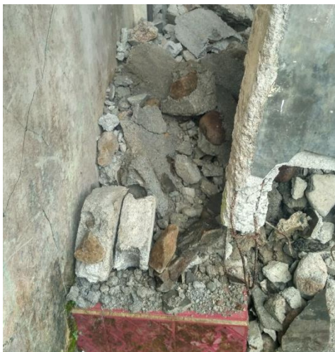
Gambar 6. Kegagalan Sendi Plastis pada Kolom Sumber: Kunjungan Lapangan (2018)
