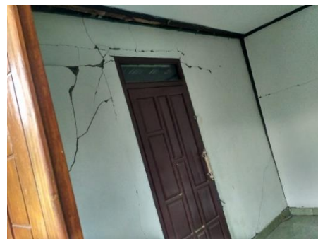
Gambar 11. Keretakan Dinding pada Frame Pintu Sumber: Kunjungan Lapangan (2018)
