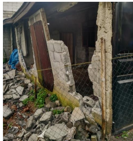
Gambar 10. Keruntuhan Dinding pada Frame Jendela Sumber: Kunjungan Lapangan (2018)
