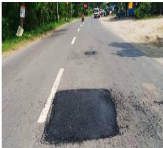
Gambar 12 Hasil dari Perbaikan Kerusakan Jalan Sumber : UPT Pengelolaan Jalan dan Jembatan Kabupaten Mojokerto
