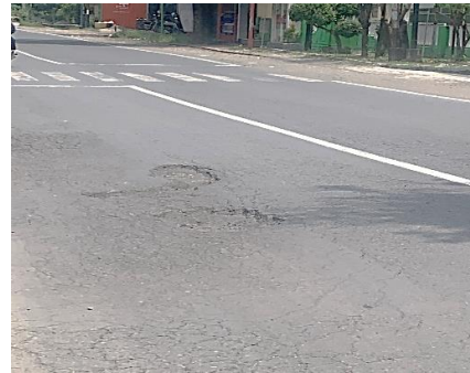
Gambar 10. Kerusakan Lubang dan Rerak Buaya Sumber : Survei
