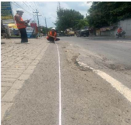
Gambar 8 Pengukuran Panjang dari Kerusakan
