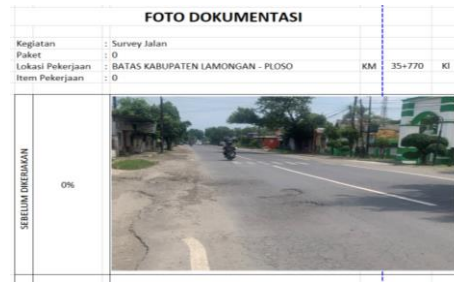
Gambar 2 Dokumentasi Survei Kerusakan
