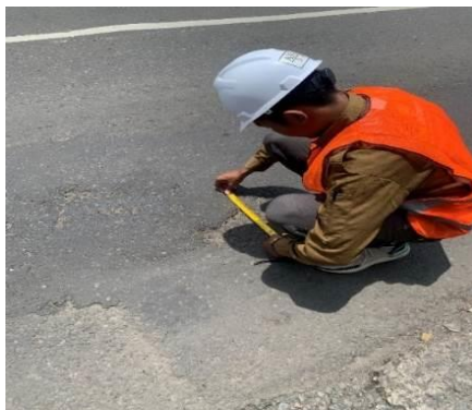
Gambar 9 Pengukuran Lebar dari Kerusakan
